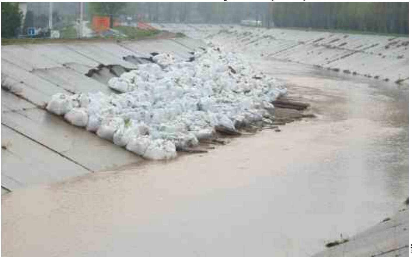
Le Reyran canalisé, endommagé par les inondations de novembre 2011. Fréjus
